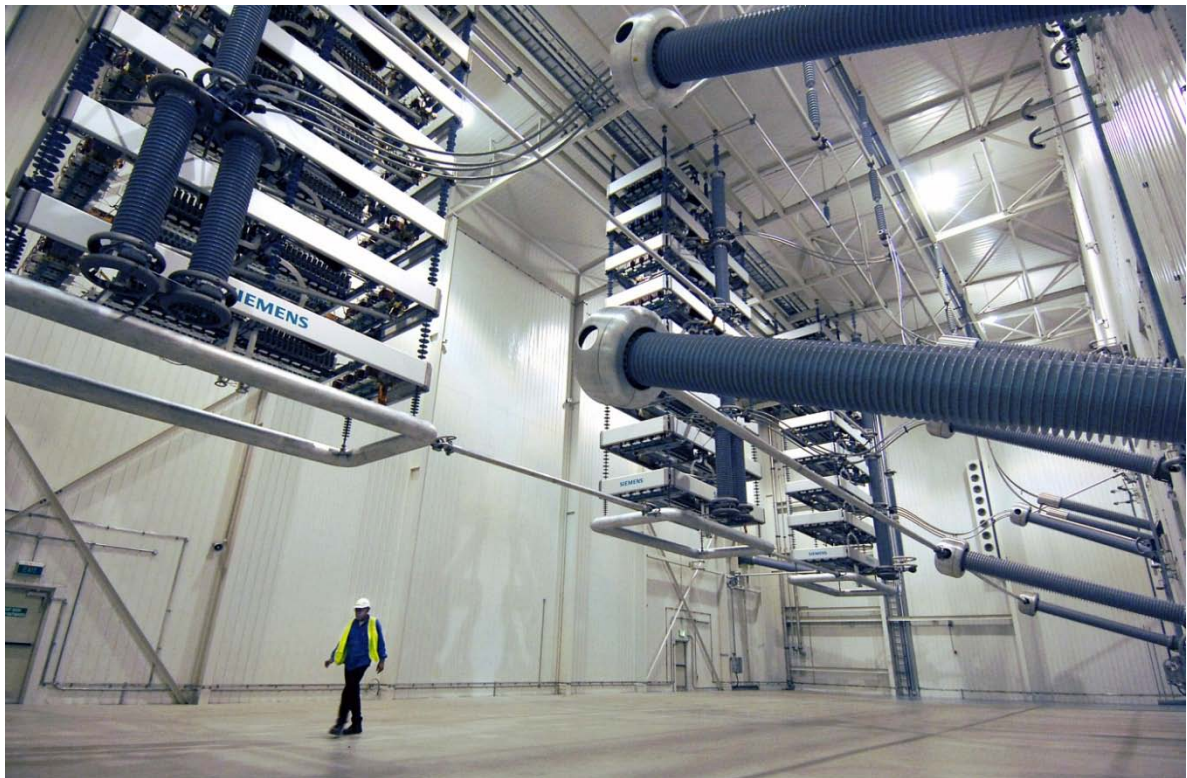
Billede 3. Højspændingsthyristorer i en moderne transformatorstation for omdannelse af højspændt vekselstrøm til jævnstrøm. Kilde: www.siemens.de .
